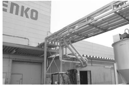
工場から直接ポテトピールを移送するパイプライン
