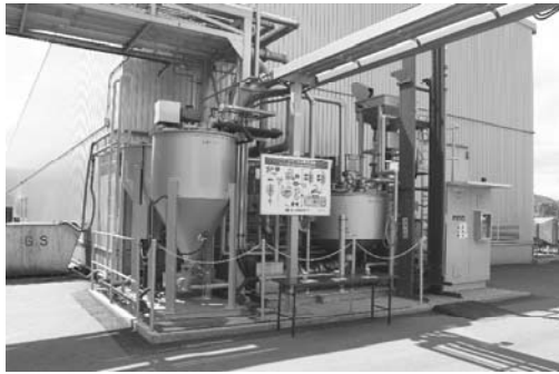
定量タンクとミキシングタンク
