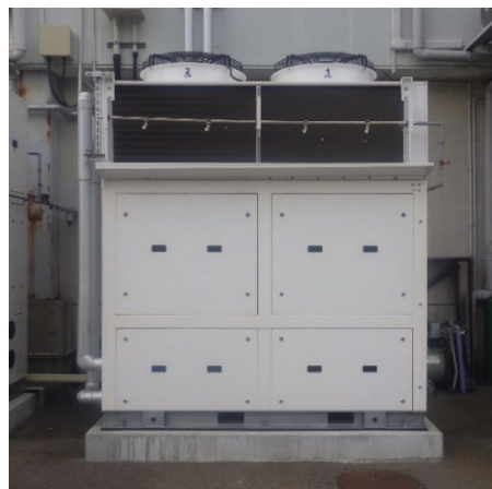
↑御殿場工場で導入したグリーン冷媒機器
